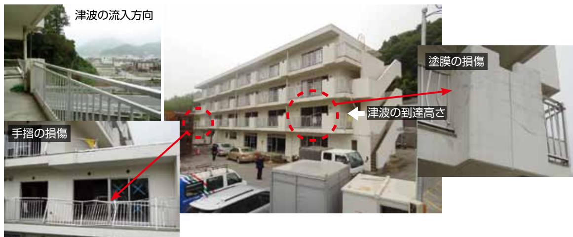
写真1 津波による被害を受けた寮 [RC造, アロンウォール ST 工法, 施工後31年経過]
