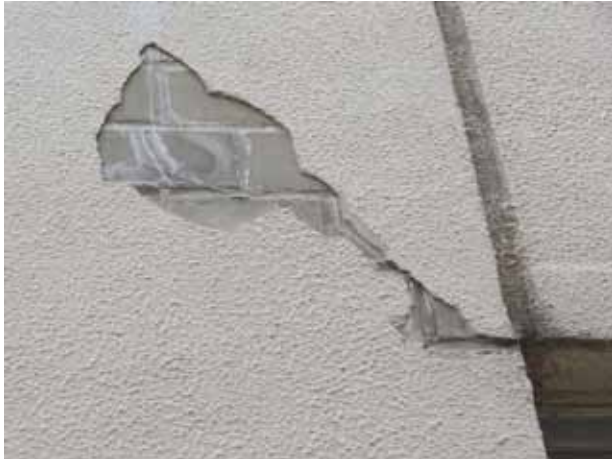
写真 15 タイル上に塗布したモルタルの剥離・剥落
