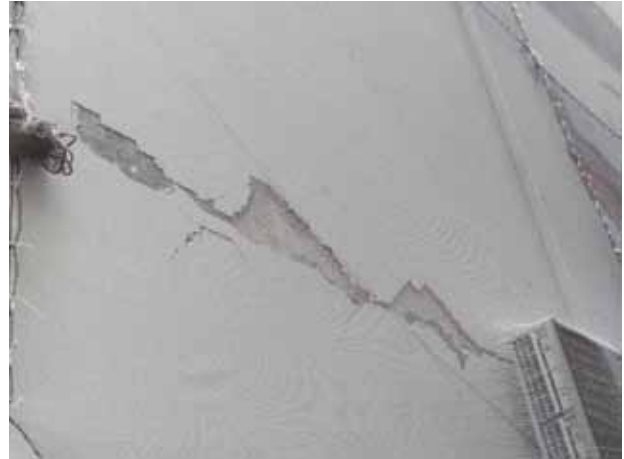
写真 16 吹付けタイルが塗装されたモルタルの剥離・剥落
