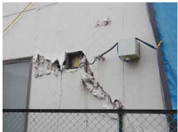
写真 18 縦張りした ALC パネルの損傷
