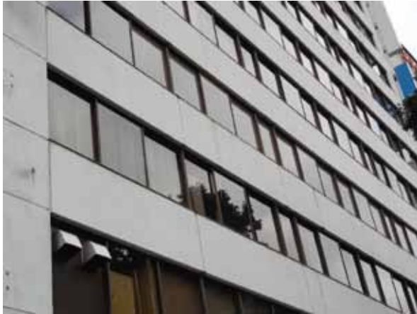
写真 2 商業施設 [RC 造, 1974 年竣工, アロンウオール ST 工法, 施工後 25 年経過]
