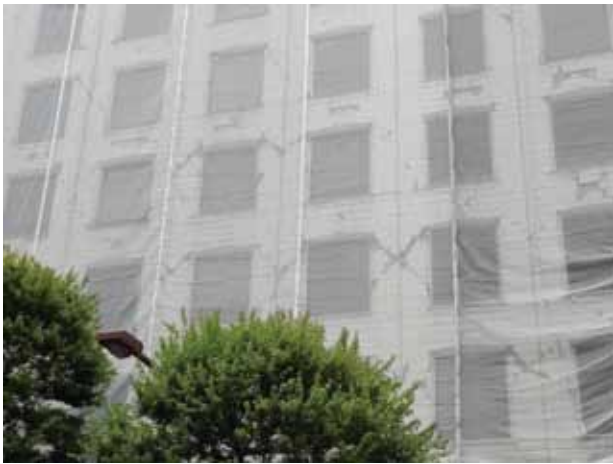
写真19 コンクリート下地のせん断ひび割れによるタイルの剥離・剥落
