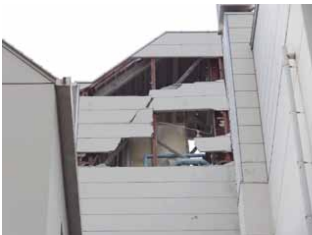
写真 17 横張りした ALC パネルの割れ・剥落
