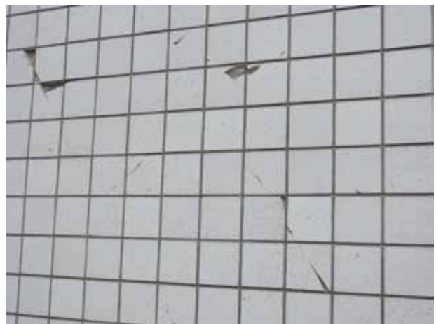
写真22 接着性の良好なタイルの割れ欠け
