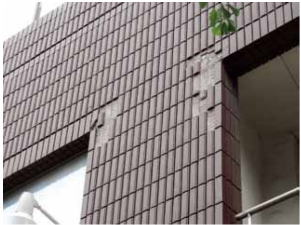
写真20 目地モルタルの厚み不足によるタイルの裏足破断
