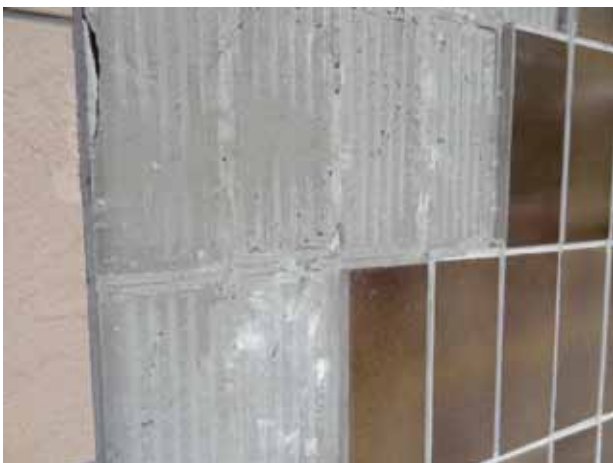
写真21 タイルと張付けモルタルの剥離
